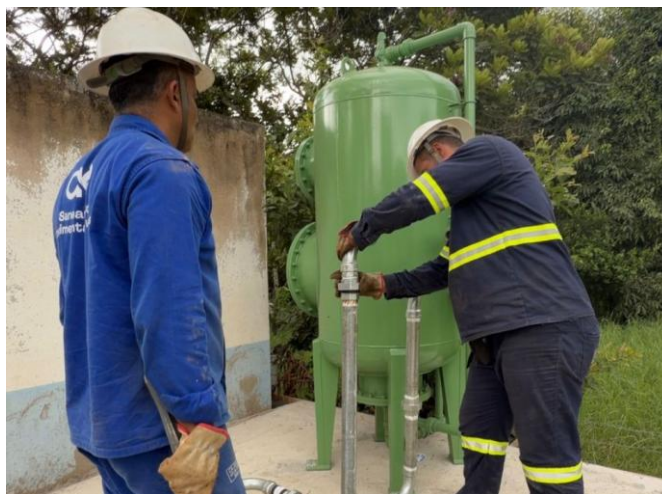
Figura 19 – Águas de Valadares instala filtros de zeólita nos distritos
