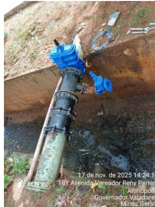
Figura 109 - Instalação de registro 250mm e 100mm para descarga na Av. Vereador Reny Pereira
