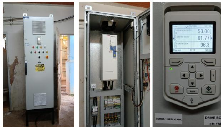
Figura 146 – Instalação de QCM com inversor de frequência – ETA Pontal
