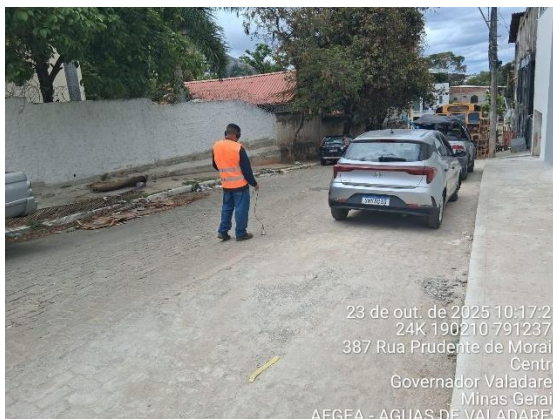
Figura 33 - Verificação de vazamentos com Geofone
