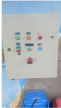
Figura 147 – Instalação de QCM com inversor de frequência para motobomba – ETA Penha
