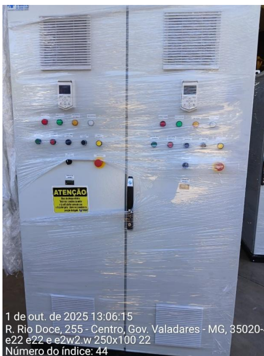
Figura 24 - Fornecimento de painel elétrico com inversor de frequência
