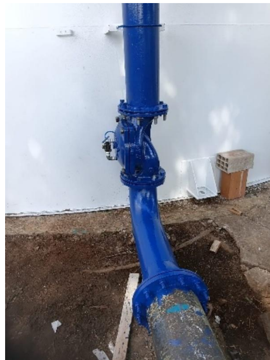
Figura 97 – Instalação VRN Reservatório Braúnas.
