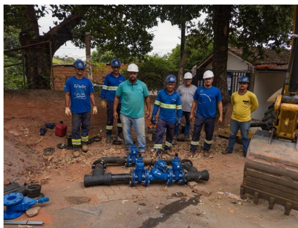
Figura 58 – Tecnologia: redes do Trevo receberam equipamento que regula a pressão da água para evitar vazamentos
