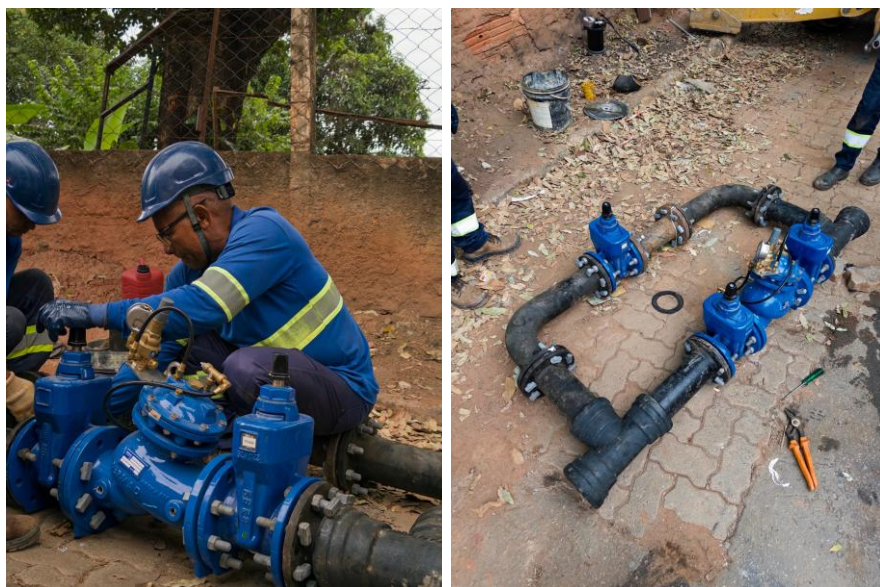
Figura 57 – Tecnologia: redes do Trevo recebem equipamento que regula a pressão da água para evitar vazamentos
