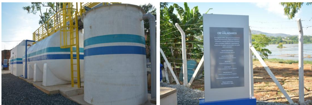
Figura 45 – Encerrando a Semana do Meio Ambiente, nova estação de tratamento de esgoto foi inaugurada pela Águas de Valadares e Prefeitura
